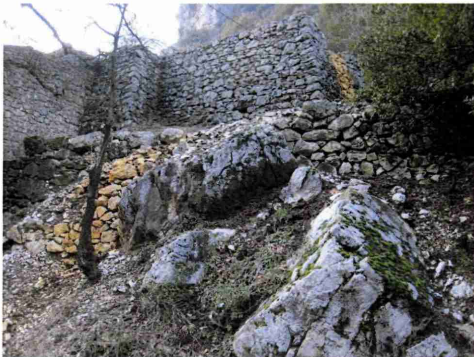
Figure 9 : Saint-Laurent le Minier - Indices visuels de suintement / lixiviation à « Machu Pichu » (31 janvier 2011 BRGM-INERIS)
