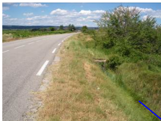
Photo 2 : Fossé pluvial de la RD 192
